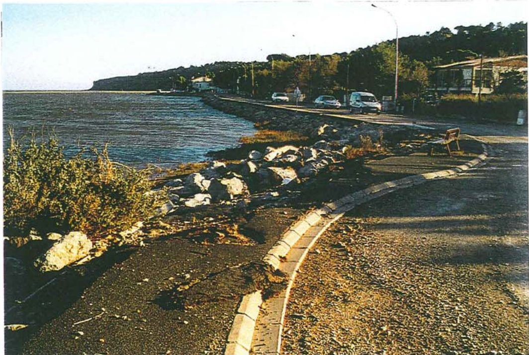
Photo n° 10 - Très en arrière du rivage, le talus bordant la route est endommagé
