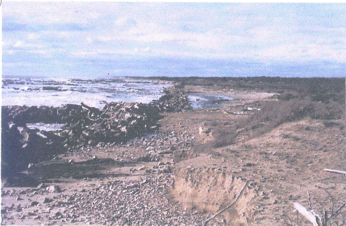
Affaissement de la digue frontale et forte érosion des terres du au franchissement.
