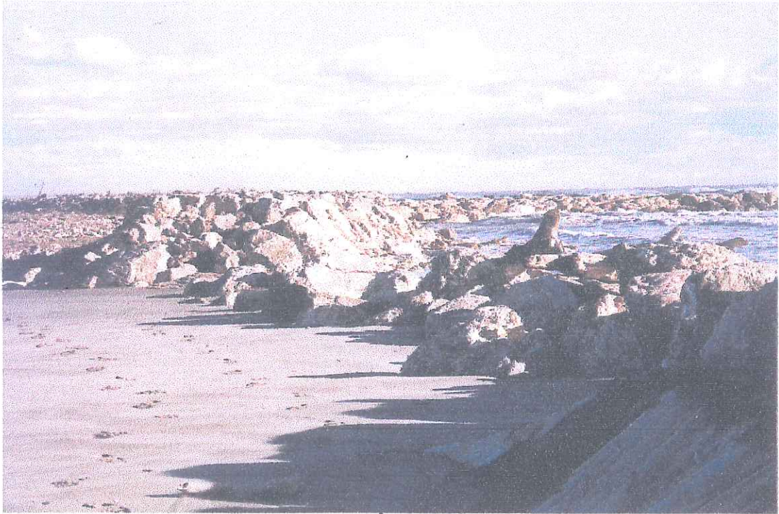
destruction de la digue frontale a l'embarcadere du petit Rhone.
