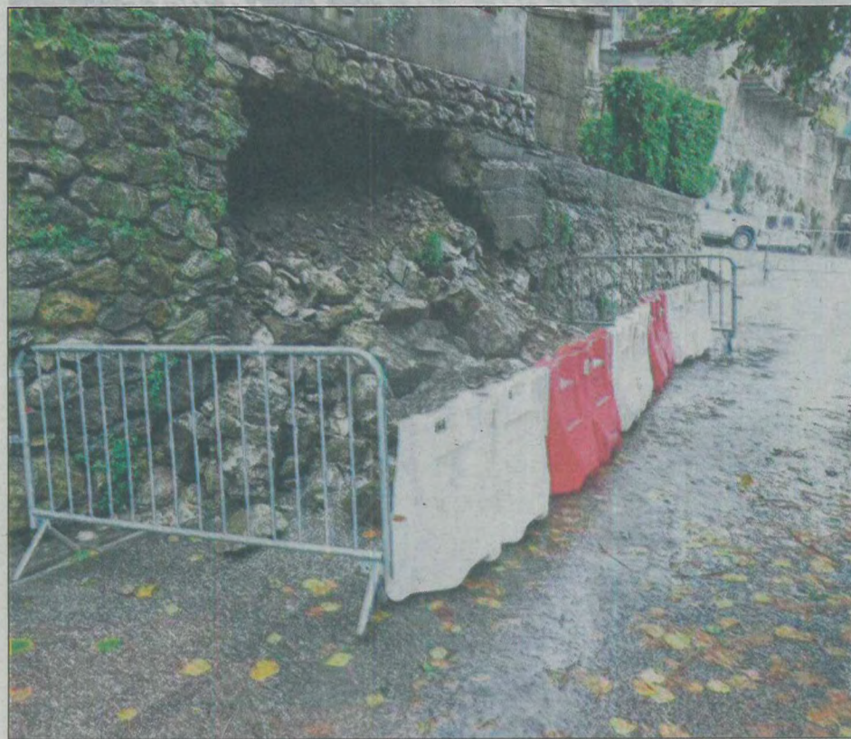
Les gravats obstruent une partie de la chaussée, rendant la circulation impossible dans cette artère à sens unique.
