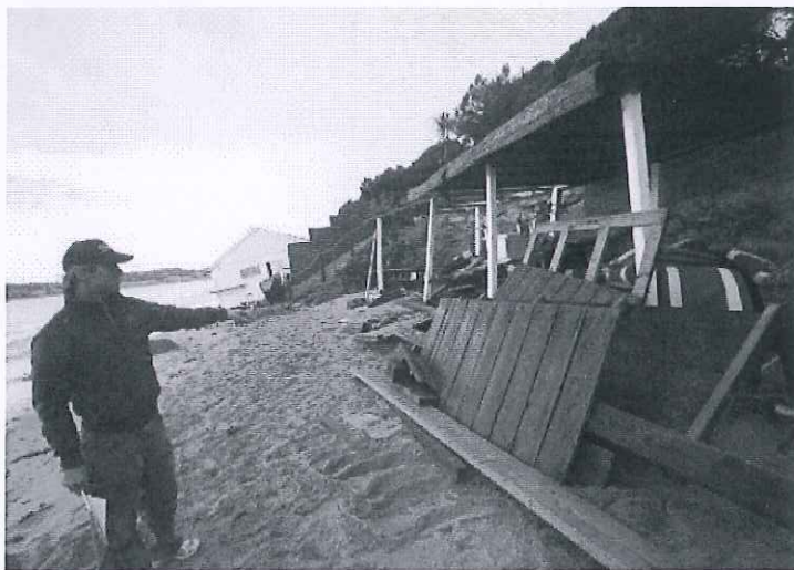
À Cavalaire, plage des Dauphins, la structure a été submergée par les eaux. M. Beaulieu, le propriétaire constate les dégâts. CAROLA CZERNECKI
